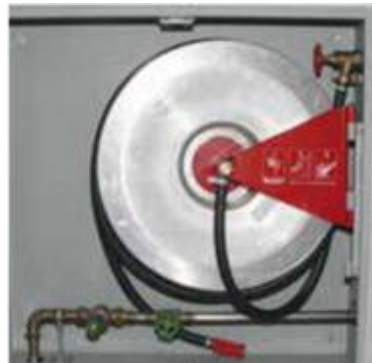
Poste d'incendie (ou dévidoir axial)
